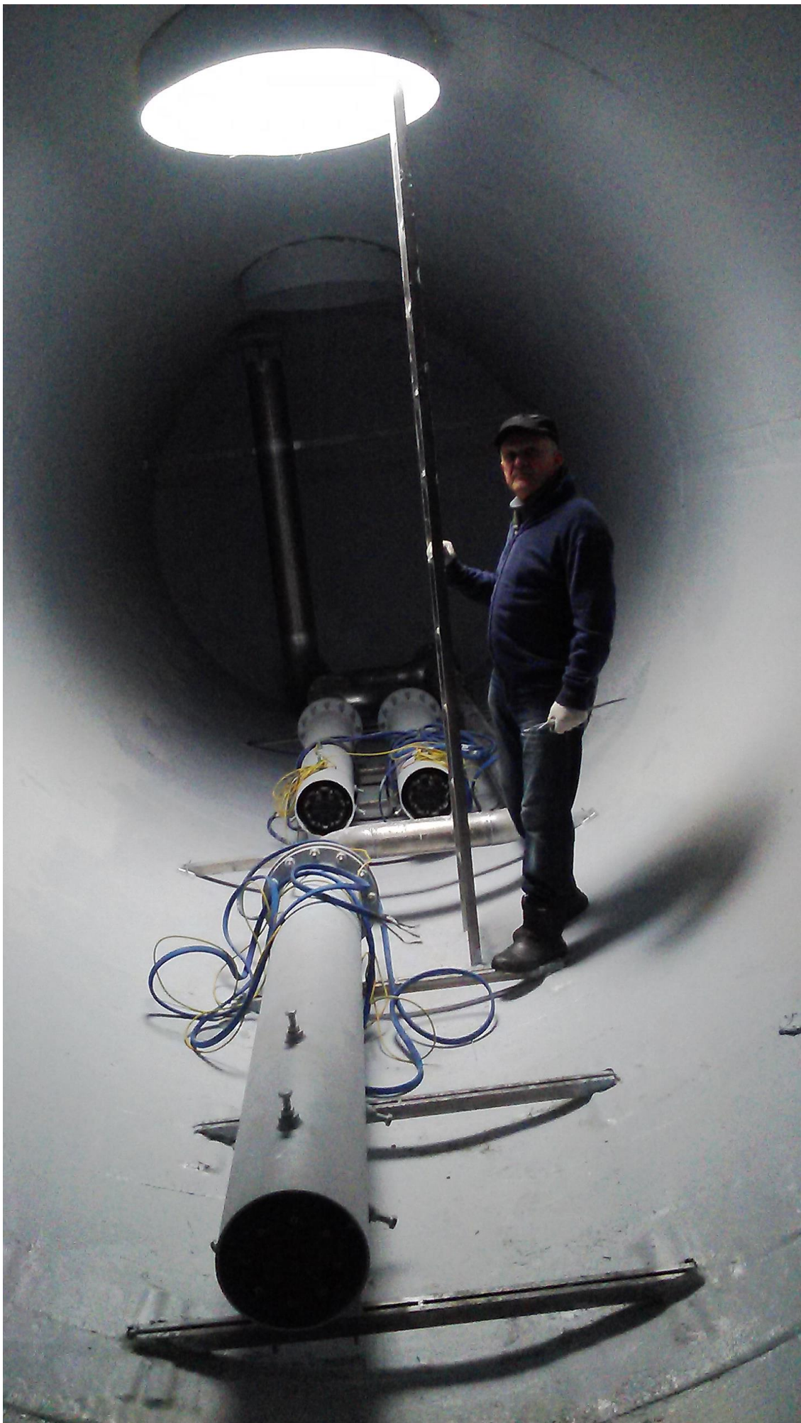
Фото трех горизонтальных бустеров внутри модуля
